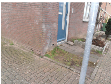
Verzakkingen openbare buitenruimte
